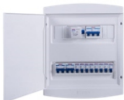
Quadro de disjuntores
