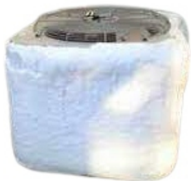
Bomba de calor congelada
