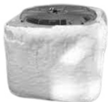
Bomba de calor congelada
